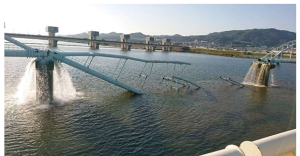
崩落した水管橋
